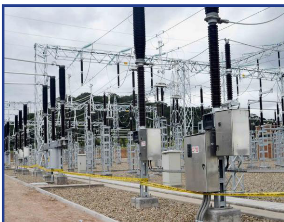
La Planta Termoelectrica del Sur, instalada en Yaguacua, Tarija, de donde se exportará electricidad este año. Foto: Archivo
